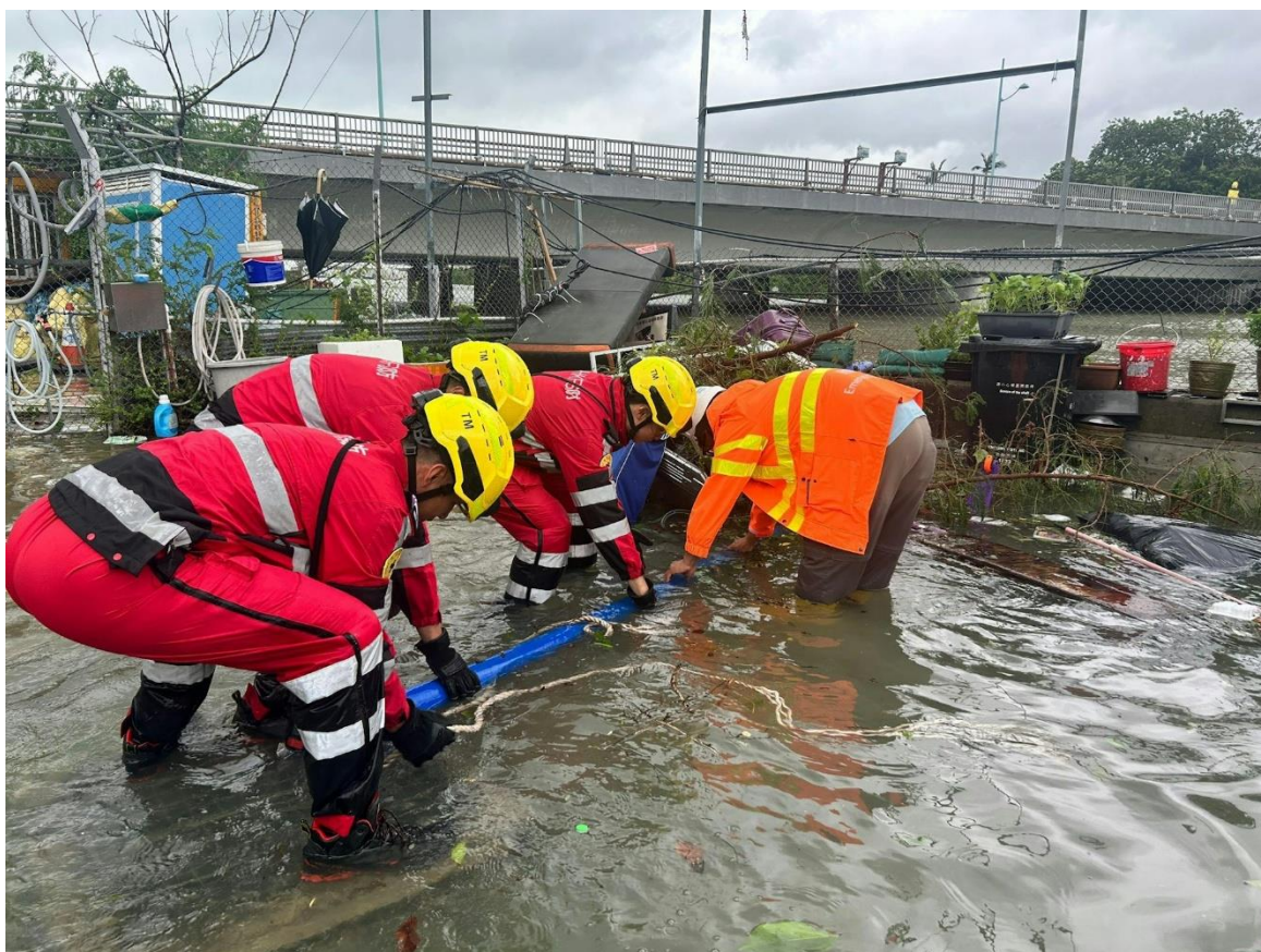
圖 2.2.22 受樺加沙引致的風暴潮影響，屯門嘉和里水位明顯上升，造成水浸。(鳴謝：渠務署)
