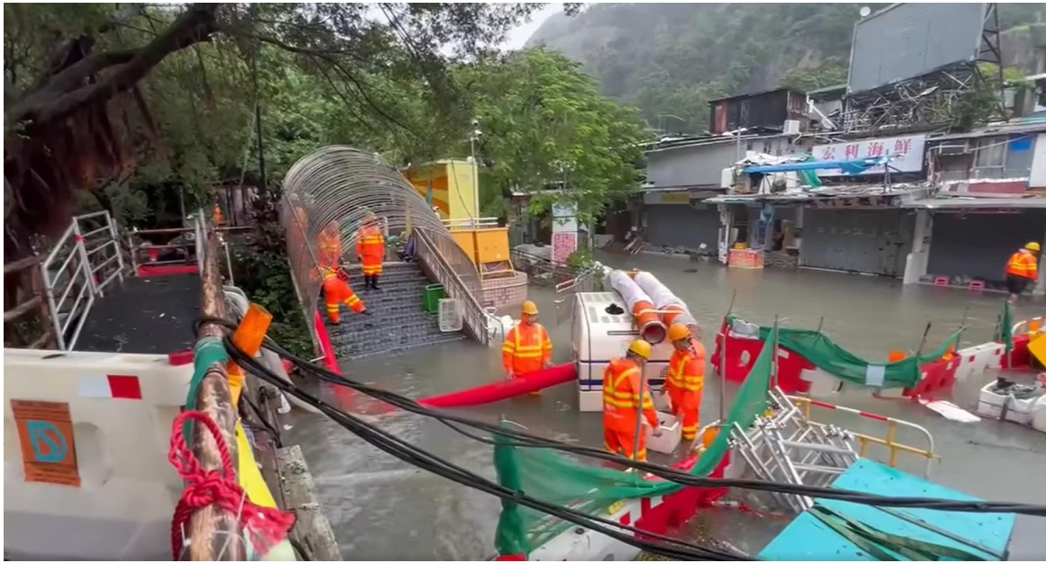
圖 2.2.21 受樺加沙引致的風暴潮影響，鯉魚門三家村水位明顯上升，造成水浸。(鳴謝：渠務署)
